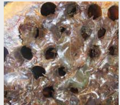
Ablagerung im Kühler
